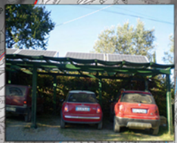
Pannelli solari installati su una pensilina
